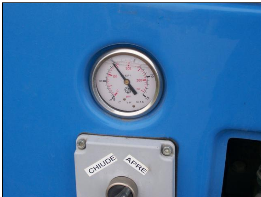
Figura 4. Manómetro a la salida de la bomba. Ingenio La Troncal
