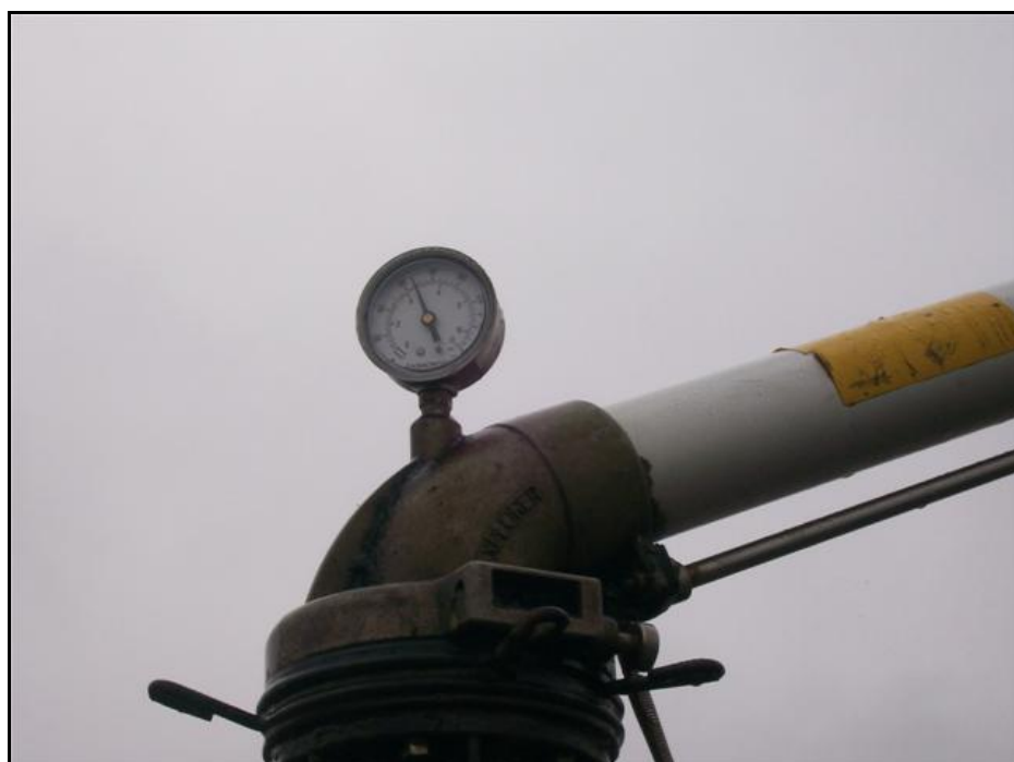
Figura 5. Manómetro en el aspersor. Ingenio La Troncal
